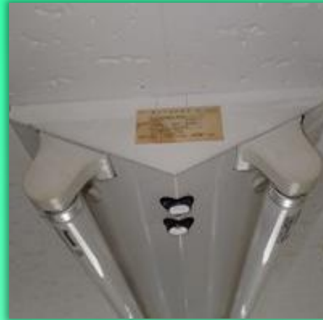
施工前 蛍光灯
